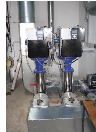
Netzpumpen in der Heizzentrale auf dem Bäumlehof
